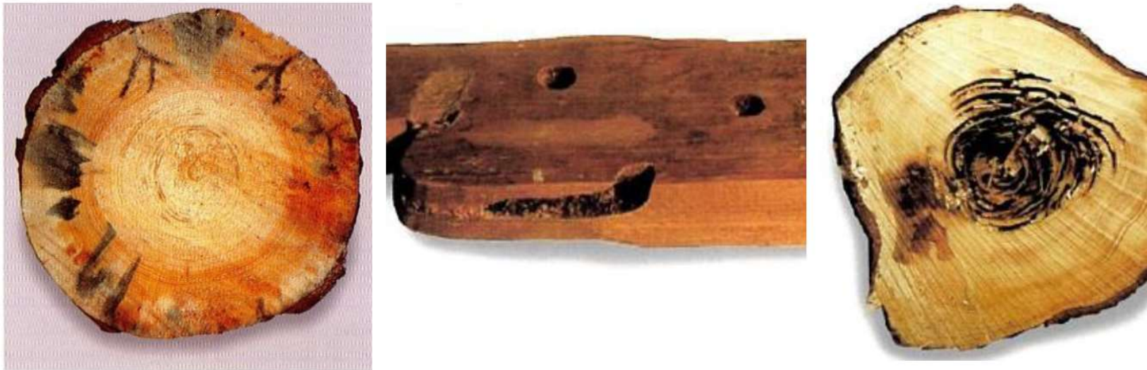
Figur 29. Exempel på insektsskador: randig vedborre, vänster, timmerman, mitten, hästmyra, höger. (Skador och fel på tall- och grantimmer, Nylinder M. m.fl. SLU, 2000).
